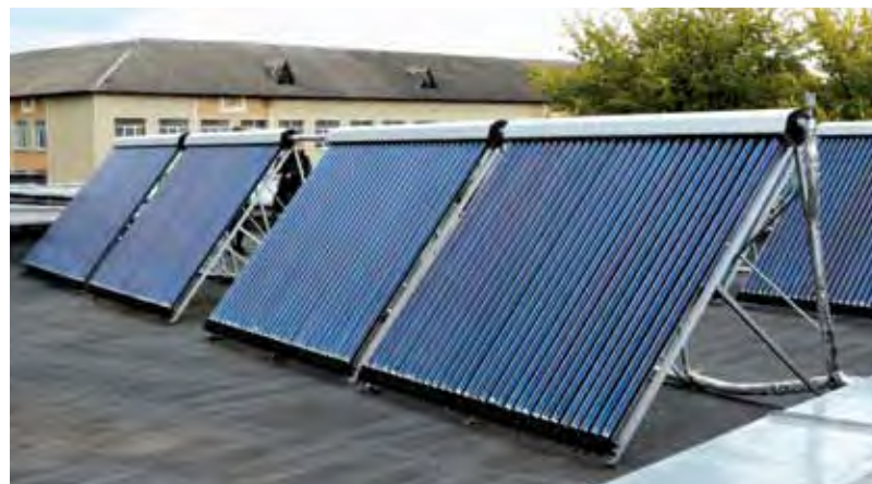
Сонячні колектори встановлено на даху дитсадка «Золота рибка»
